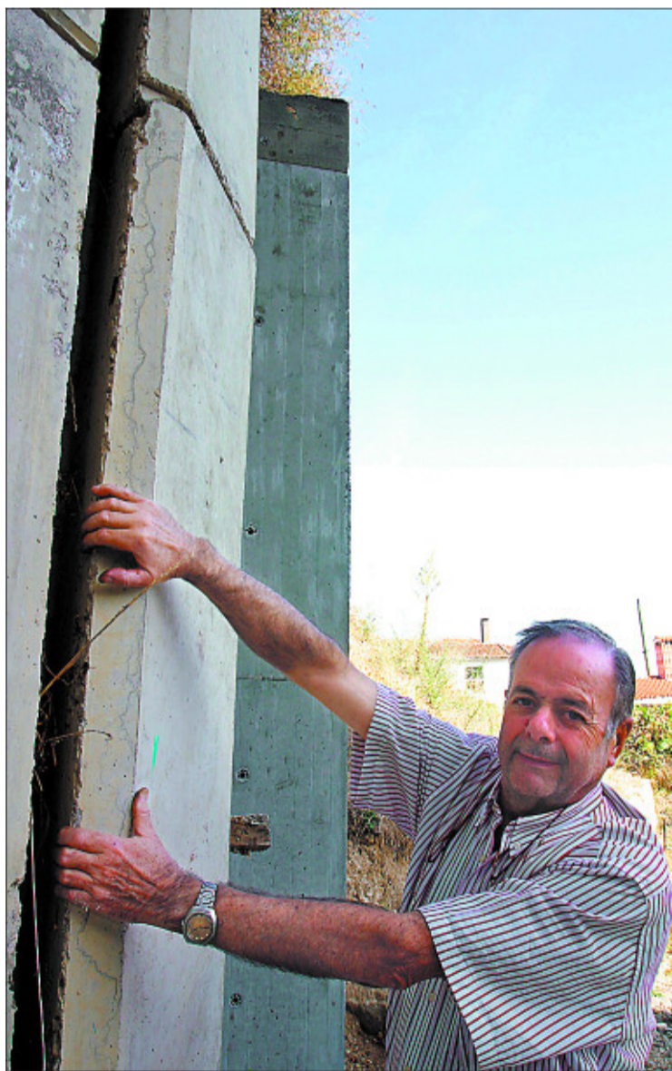
Un vecino muestra las grietas del muro de contención del talud. / J. V.
